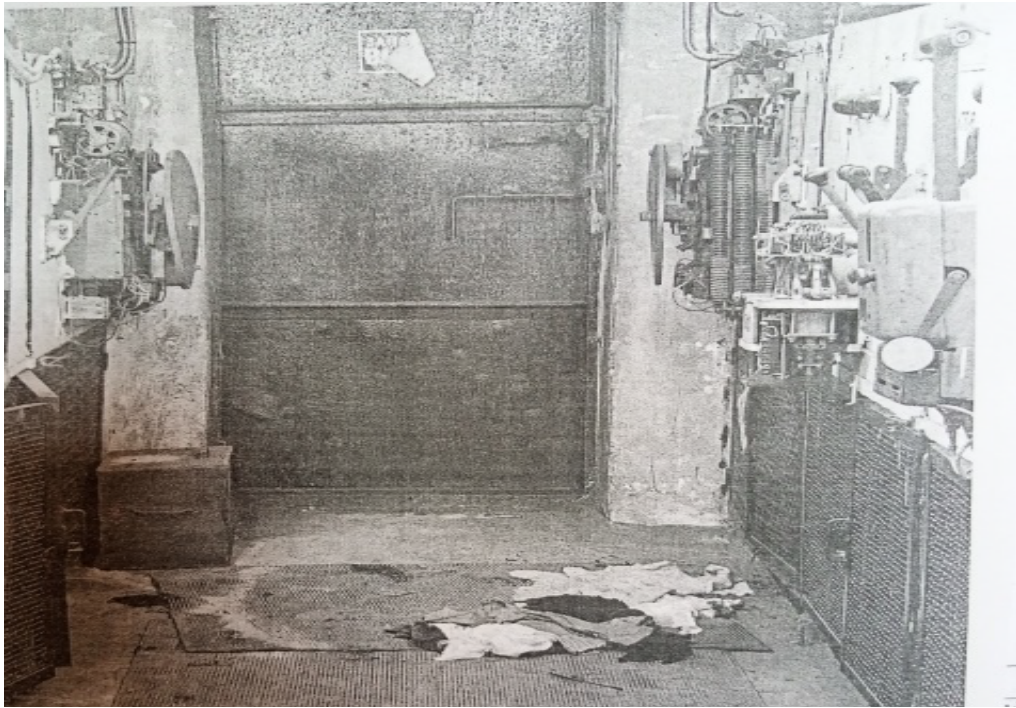
Разъединитель в кабельном отсеке ячейки № 10 РУ-6кВ ТП-2
