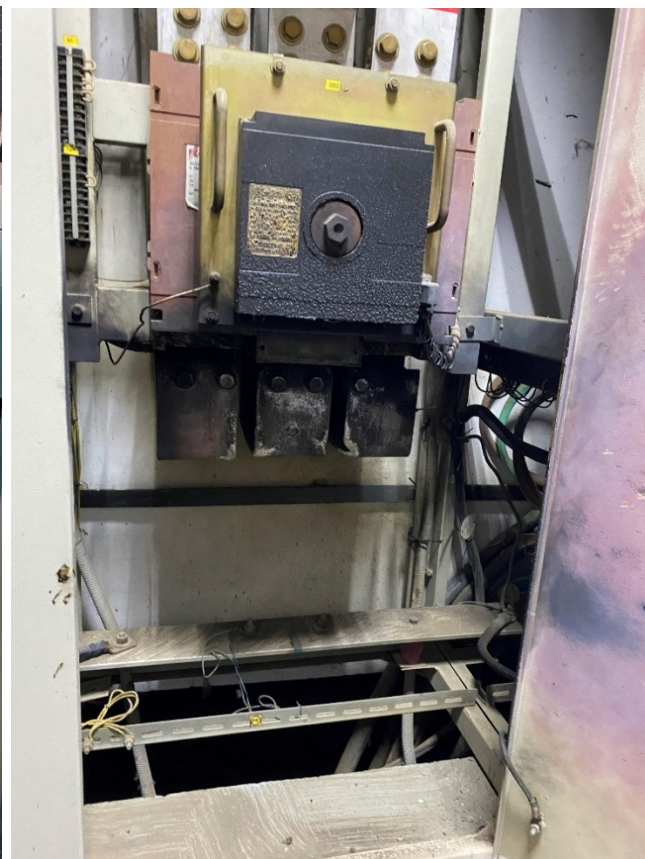
Шкаф 0,4 кВ № 2 «Перекресток ввод № 2»
