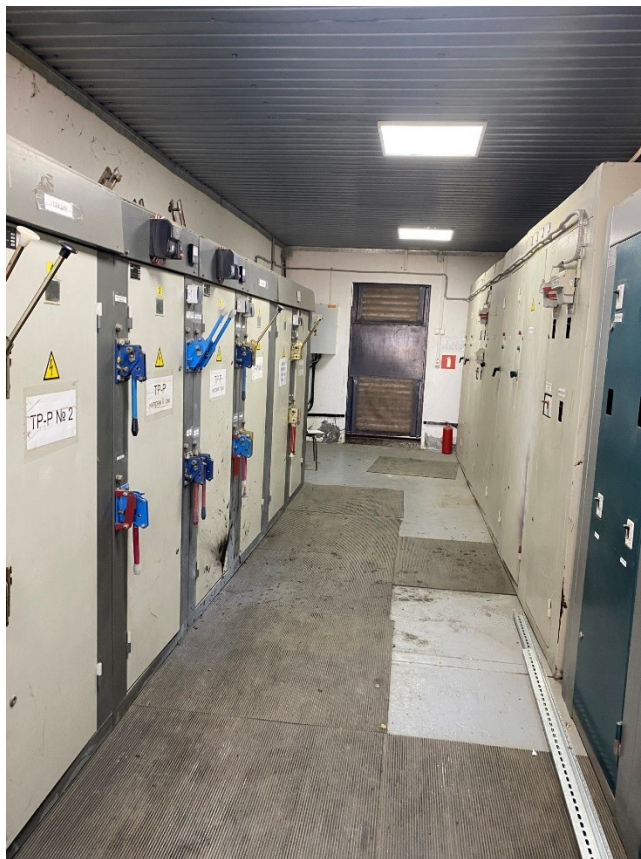
ТП (ЗРУ 6/0,4 кВ)
