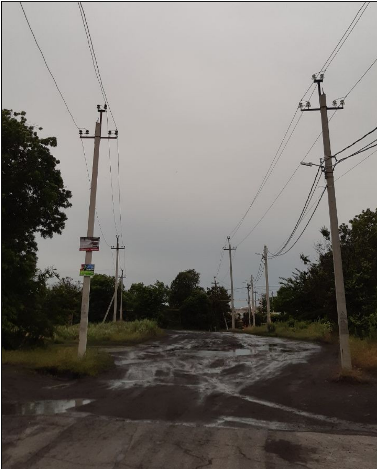
Воздушные линии электропередачи 6 кВ Л-815 (левее) и Л-805 (правее)
