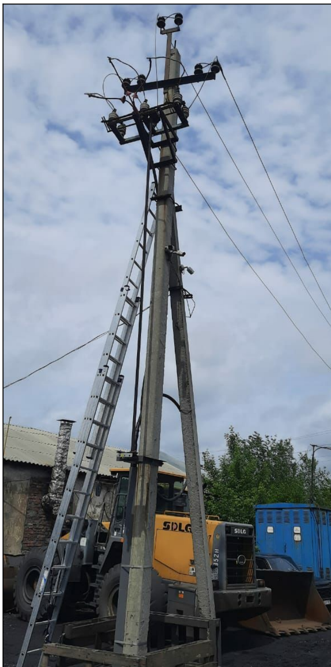
Опора № 7/1 воздушной линии электропередачи 6 кВ Л1-815
